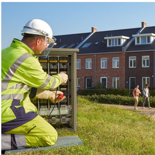
Netbeheerders zijn bezig met het uitbreiden van het elektriciteitsnet. Foto: Fotofocus
